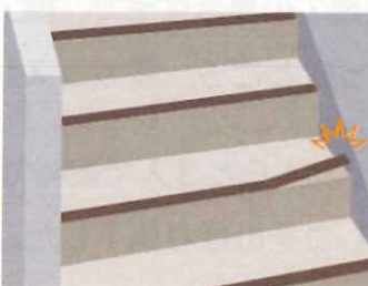
階段の滑り止めの浮き
